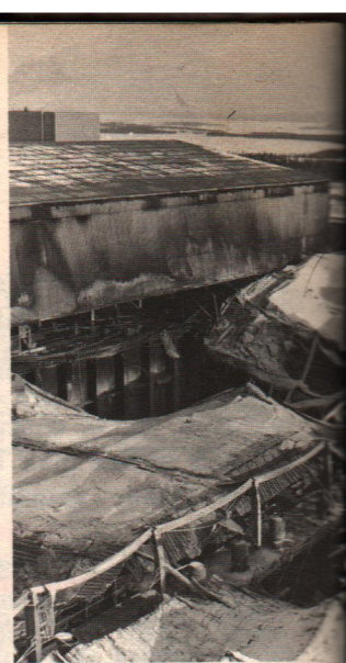
La chaleur intense engendrée par l'incendie au-dessus des broyeurs (au-dessus des broyeurs) à l'intérieur a été enfouie sous les débris. Les réparations ont débuté en février et les murs remplacés plus de 1,500 sections endommagées, ont été expédiées et réparées. Kaiser of Canada a fourni sur les lieux leur personnel.
